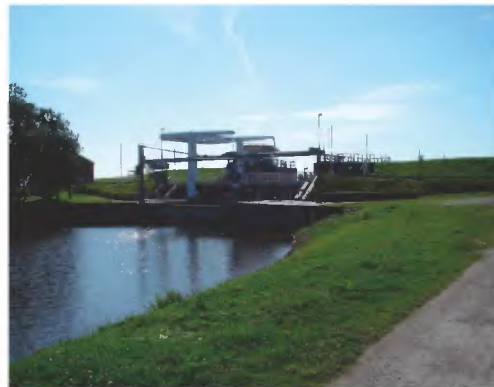
Schöpfwerk am Leybucht- und Pedalstation
